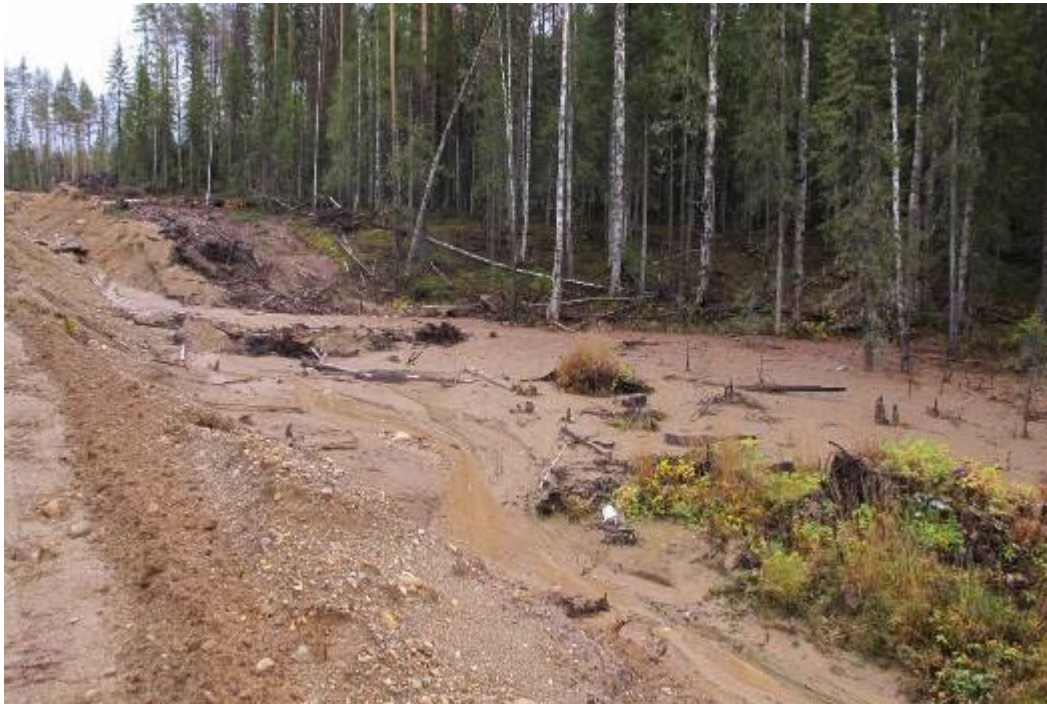
Tie on syöpynyt voimakkaassa sadekuurossa. Kuva: Ilppo Greis.
