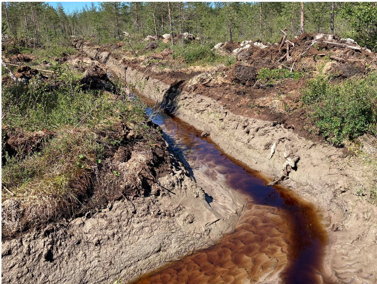
Exempel på ett istandsatt dike där material har sedimenterats på grund av erosion uppströms. Bild: © Tiina Ronkainen.
