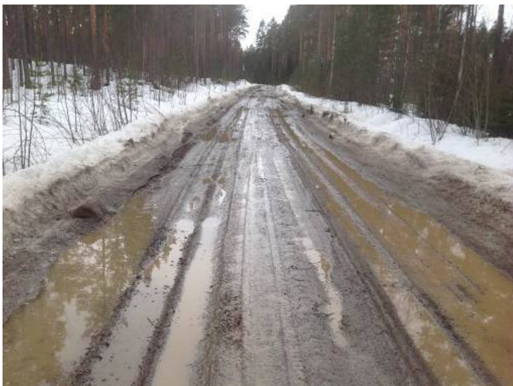
Ytliga tjälskador på en skogsbilväg. Plogvallarna och kantvallarna hindrar vattnet att rinna bort från vägytan, vilket förvärrar situationen. Bild: Martti Perälä.
