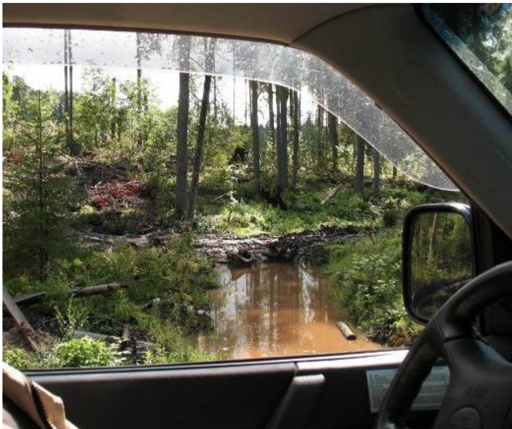
Ett körstråk har täppt till ett avloppsdike från en skogsbilväg. Vägen blir snabbt mjuk om inte diket rensas. Bild: Ilppo Greis.
